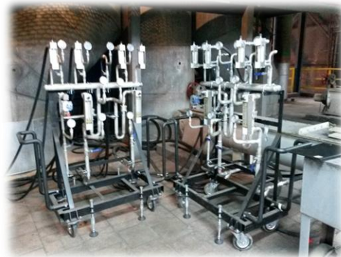
MOBILNA STACJA SNCR DO PRZEPROWADZANIA TESTÓW MOBILE SNCR STATION FOR CONDUCTING TESTS
